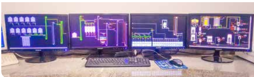
Painel de controle na Unidade Industrial de Rações - Equipamentos e processos são automatizados, para garantir a padronização e qualidade em toda linha produzida
