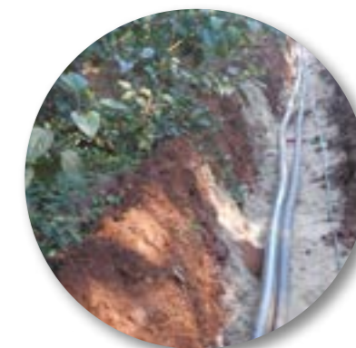
O GASODUTO INSTALADO TEM CAPACIDADE DE CONDUZIR ATÉ 120M 3 DE GÁS POR HORA
